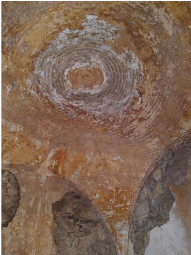
Fig.4. Bóveda vaída del cuerpo alto del “castillo fuerte” de la Torre de Melgarejo.
