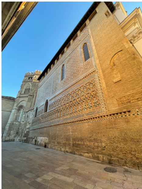
Fig. 4. Muro exterior de la Parroquieta, catedral de San Salvador de La Seo, Zaragoza. Estado actual. Foto de la autora.
